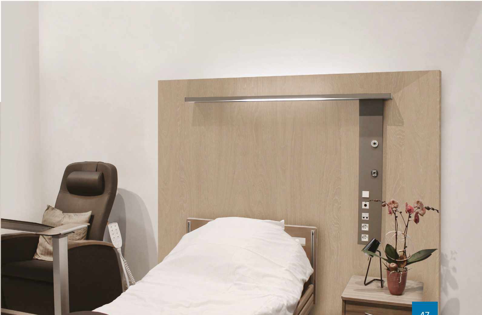
LYSA con dotazione elettrica e per gas medicale
