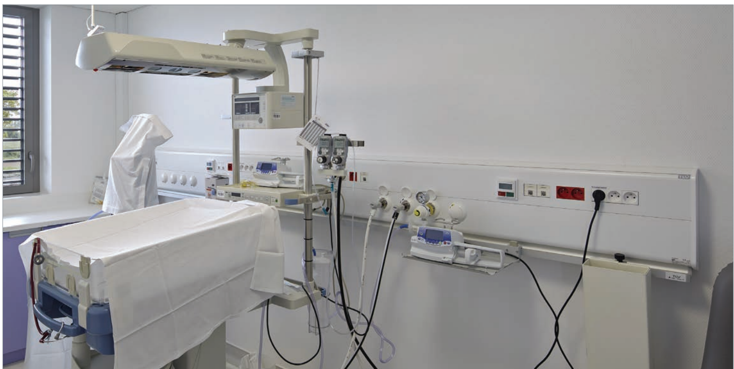
■ GAINÉ TECHNIQUE FLUIDYS HORIZONTALE, SERVICE DE NÉONATOLOGIE
