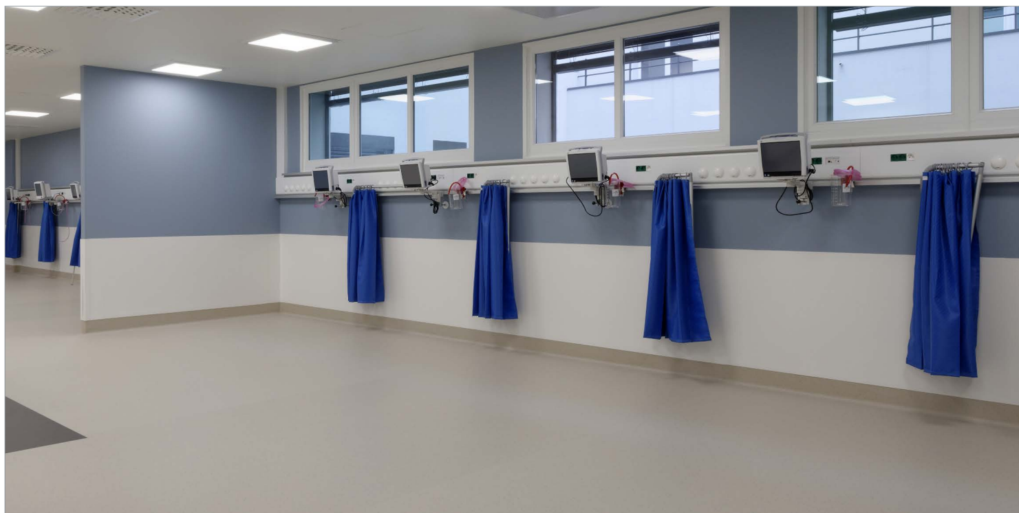
■ GAINES TECHNIQUES FLUIDYS, SALLE DE RÉVEIL
